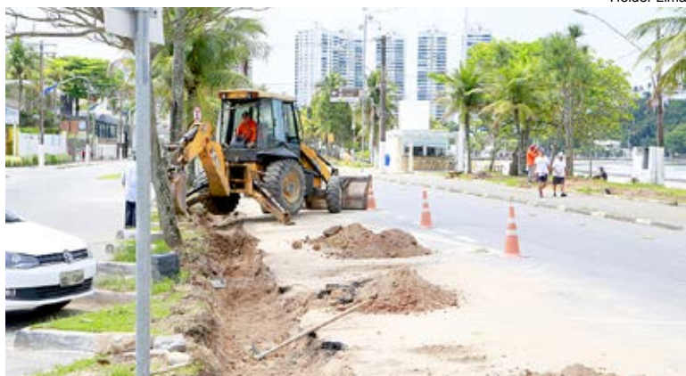
Convênios que somam R$ 14,3 milhões transformaram a Avenida Miguel Stéfno em um verdadeiro canteiro de obras
